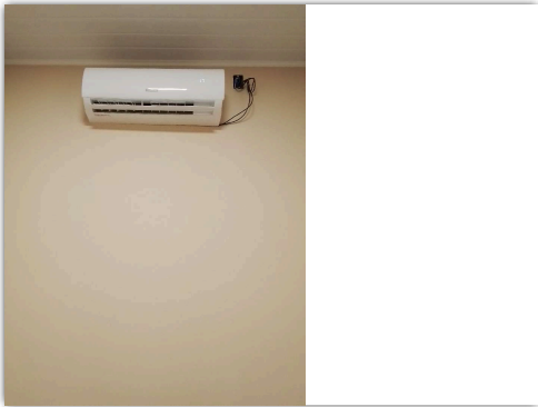
ar condicionado Patrimônio 651
